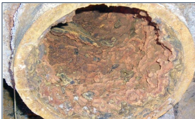
Figure IV.1 : Vieillissement des canalisations en fonte. [140]
