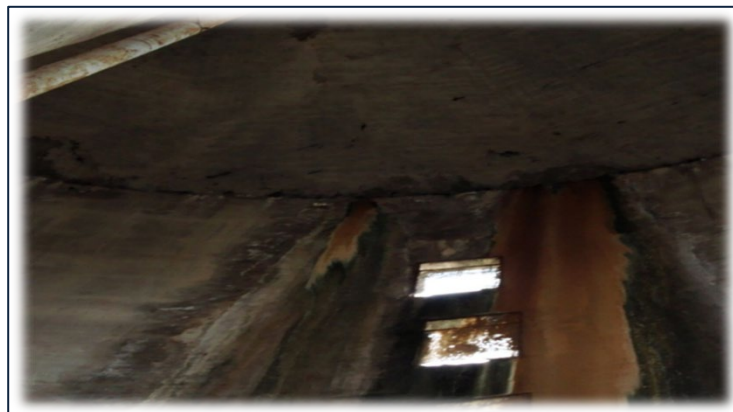
Figure II.20 : Trace d'infiltration d'eau entre la tour et la base de la cuve du réservoir 1500m 3 . [82]
