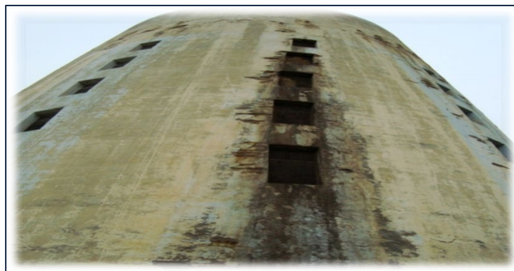
Figure II.17 : Traces d'infiltration du réservoir 1500m 3 . [82]
