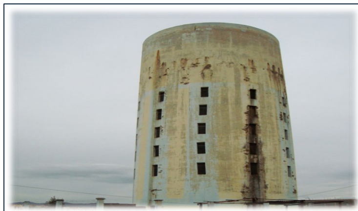
Figure II.16 : Vue générale du réservoir 1500m 3 . [82]
