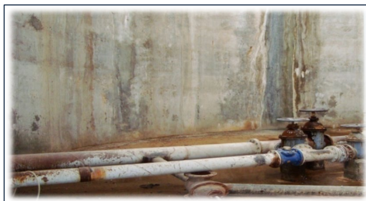
Figure II.22 : Salle de manœuvre canalisation et accessoires mal entretenus corrosion et fuites au niveau des joints. [82]
