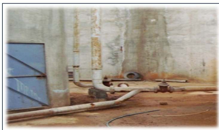
Figure II.21 : Salle de manœuvre Traces de fuite, canalisations corrodées. [82]
