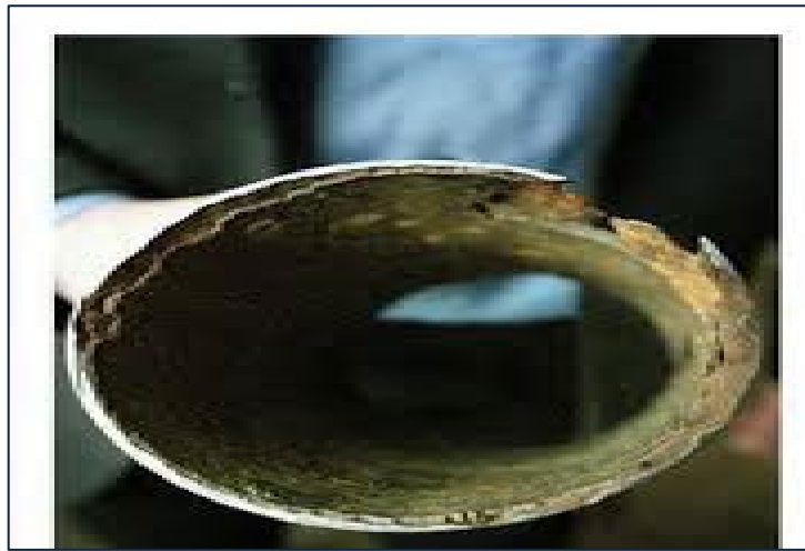
Figure IV.2 : Une conduite ayant subi une rupture en Acier. [143]
