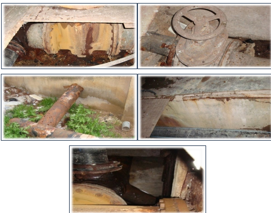
Figure II.13 : Toute la canalisation et la robinetterie intérieure du réservoir sont totalement corrodées. [82]
