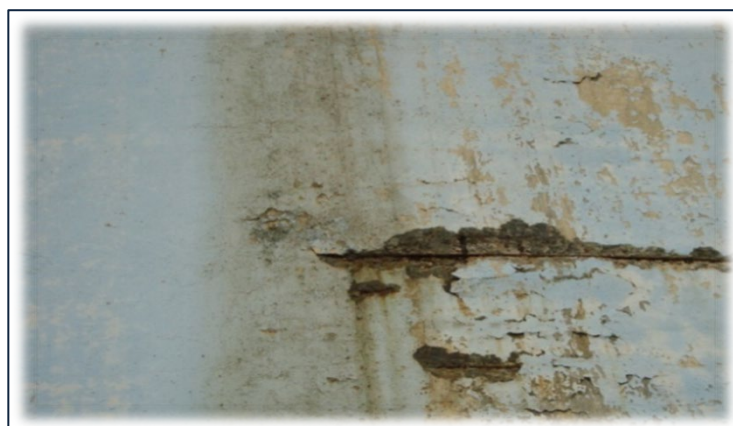
Figure II.19 : Fissure superficielle dans le corps de la Tour. [82]
