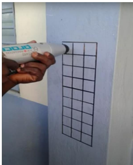
Figure I.21: Grille de mesure sur poteau
