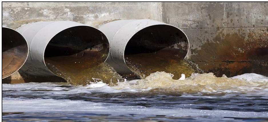
Figure 1 : la pollution des eaux usées domestiques (sideet, 2025)
