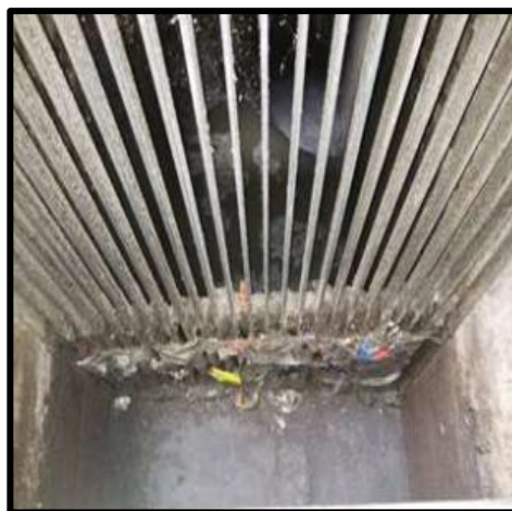
Figure 11 : dégrilleur manuelle (STEP, Sidi Merouane).
