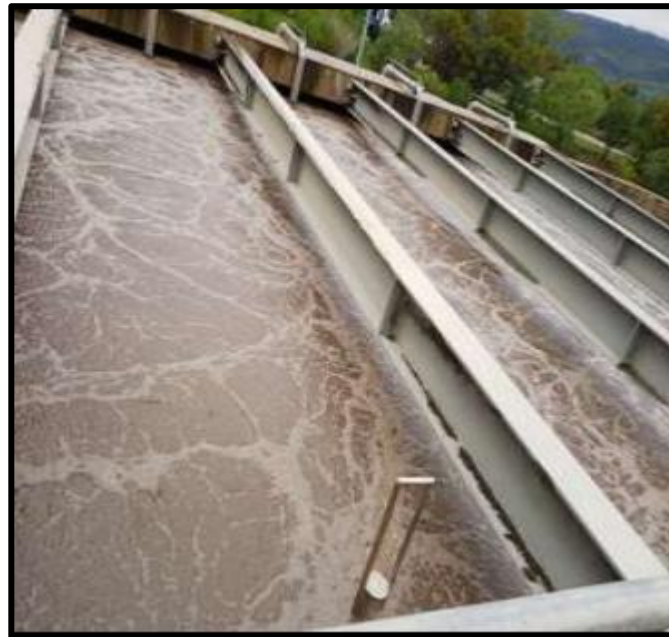
Figure 18 : Zone aérée dans le chenal (STEP, Sidi Merouane).
