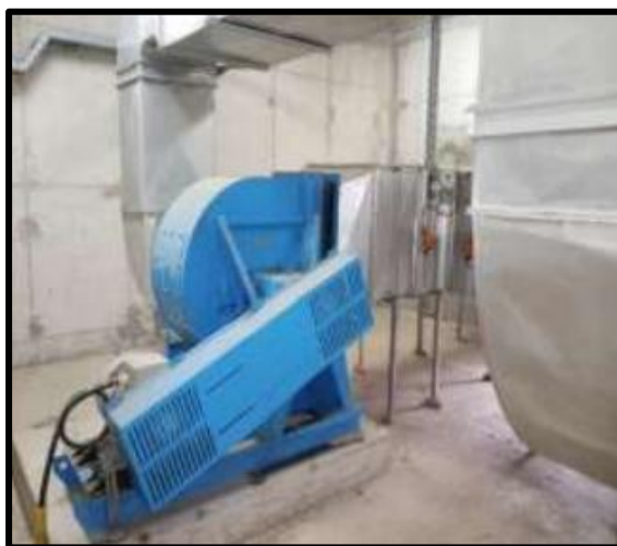
Figure 28 : le ventilateur de la désodorisation biologique (STEP, Sidi Merouane).
