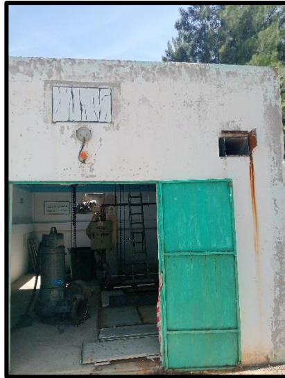
Figure 10 : Poste de relevage (STEP, Sidi Merouane)
