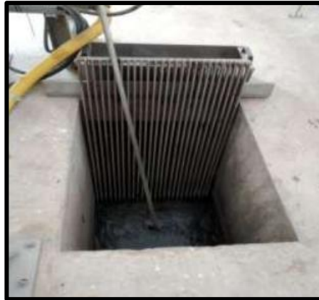
Figure 13 : dégrilleur fin (STEP, Sidi Merouane).
