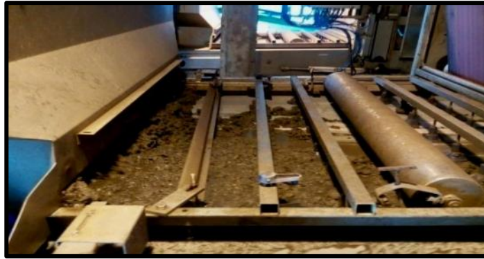
Figure 23 : Filtre à bandes-boues déshydratées (photos personnelle) (Belahmadi, 2011)
