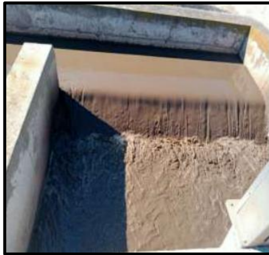
Figure 21 : la boue recirculée (STEP, Sidi Merouane).
