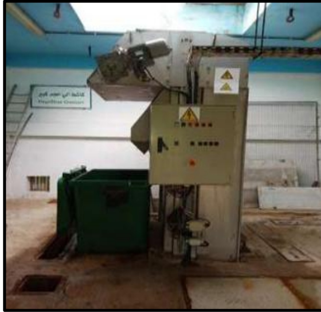
Figure 12 : dégrilleur mécanique (STEP, Sidi Marouane).
