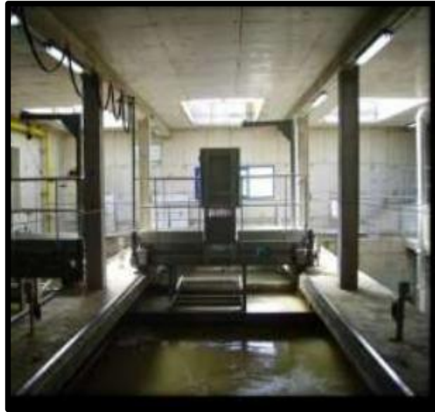
Figure 14 : dessableur/déshuileur de la (STEP, Sidi Merouane).
