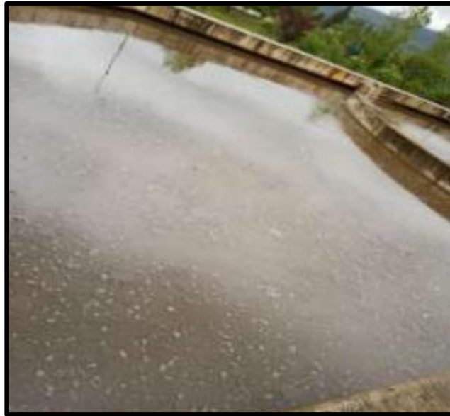
Figure 17 : zone anaérobie du bassin biologique (STEP, Sidi Merouane).
