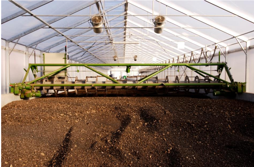
Figure 5 séchage solaire des boues– procédé Heliantis (SUEZ)
