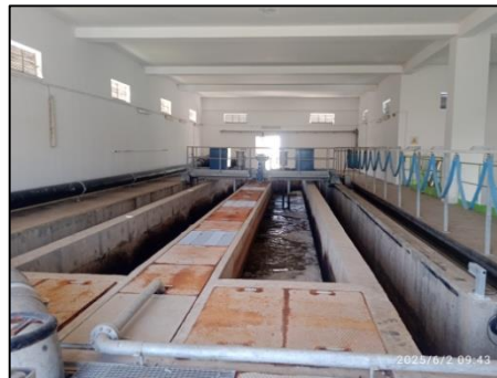
Figure 25 : dessableur et déshuileur de la STEP (Ferdjioua).
