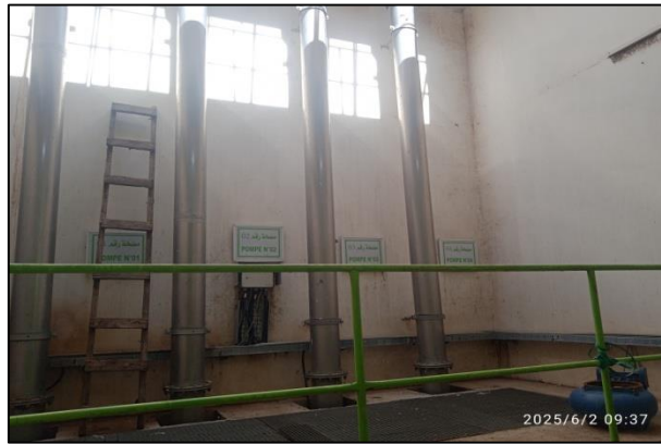
Figure 23 : les pompes de relevage (STEP Ferdjioua).
