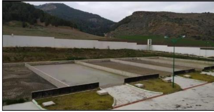
Figure 29 : Lit de séchage (STEP, Ferdjioua).
