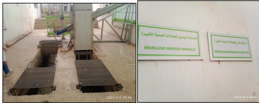
Figure 24 : le dégrilleur grossier manuel et automatique (STEP, Ferdjioua).
