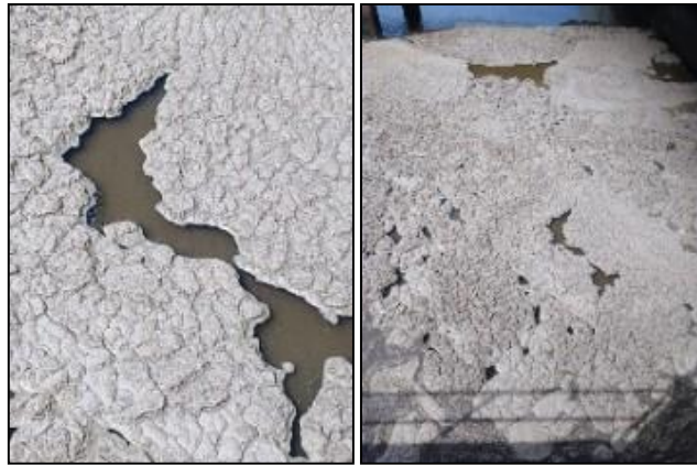
Figure 49 : Apparence visuelle de la boue activée dans le bassin d'aération (présence de mousse) de la STEP de Ferdjioua.
