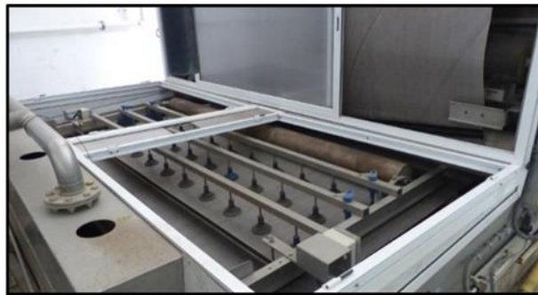
Figure 28 : déshydratation mécanique (STEP, Ferdjioua).
