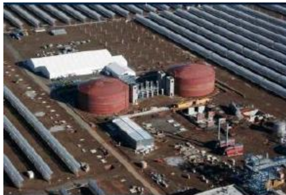
Figure V-8 Cuves de stockage thermique.
