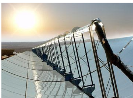
Centrale solaire à collecteurs cylindro-paraboliques
