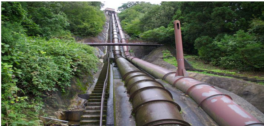
Figure IV-6 Photo de conduites d'eau.
