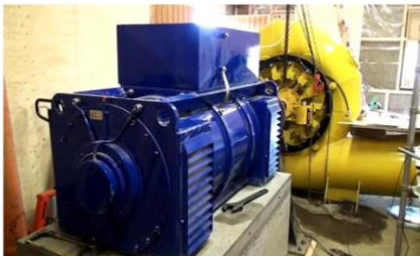
Figure IV-10 Photo d'une génératrice.
