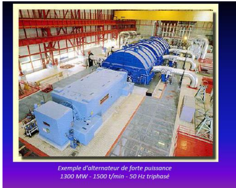
Figure I-1. Alternateur dans une salle des machines.
