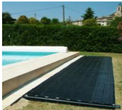
Figure V-5 Panneau solaire pour le chauffage de piscine
