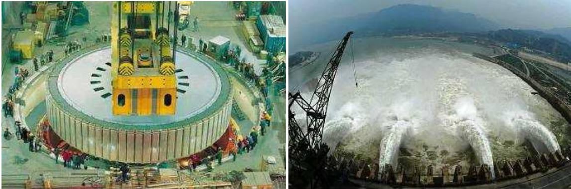
Figure IV-16 Turbine de l'une des 26 centrales hydroélectriques
