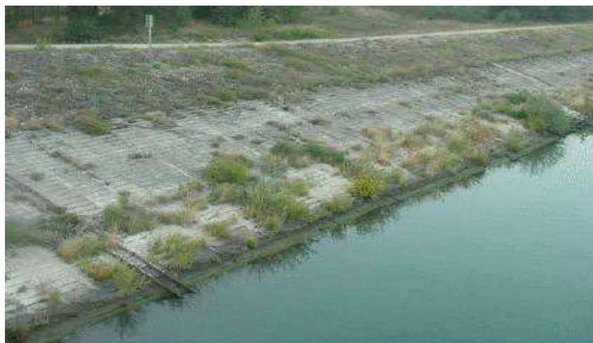
Figure 33 : Digue de navigation en charge en permanence
