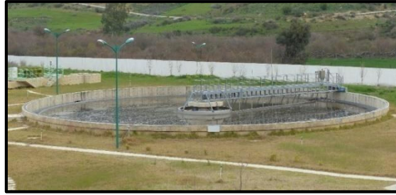
Figure 32 : Le clarificateur (STEP de Ferdjioua).
