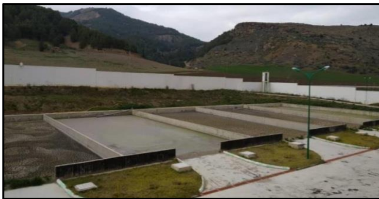
Figure 34 : Lit de séchage (STEP de Ferdjioua).
