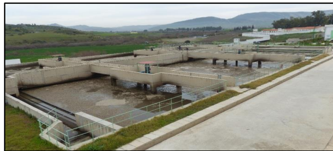
Figure 30 : Les trois bassins de traitement biologique (STEP de Ferdjioua).
