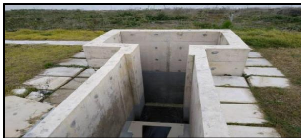
Figure 31 : L'ouvrage de dégazage (STEP de Ferdjioua).
