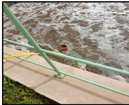
Figure 56 : prélèvement des boues activée dans la STEP.
