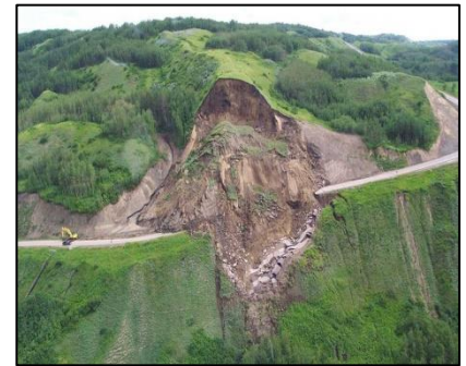
Glissement de terrain
