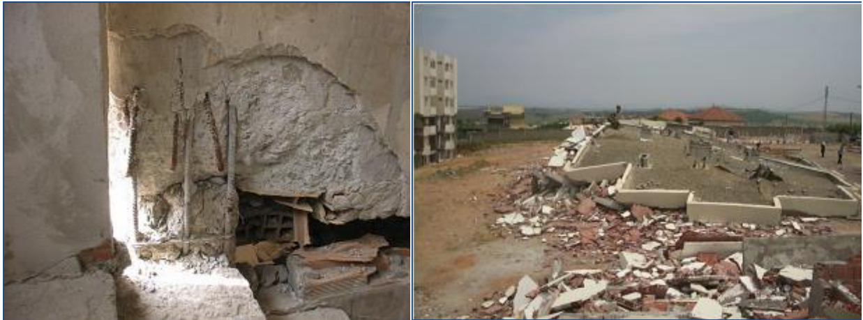
Figure I.12: Séisme de Boumerdes (Mai 2003)
