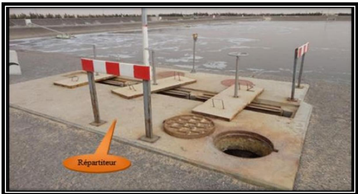
Figure III.7.: Lagunes aérées (première étape)
