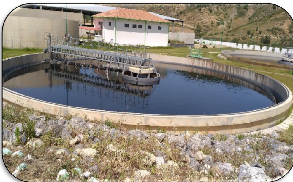
Figure 15: Clarificateur (Cliché personnel, Mai 2021).
