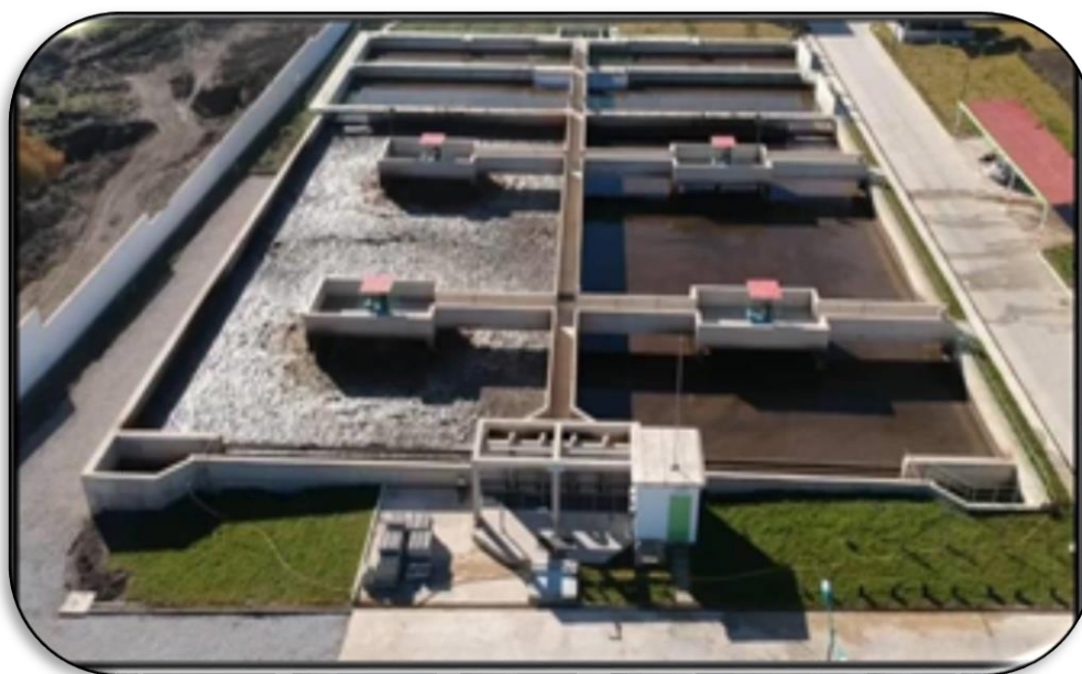
Figure 10: Les trois bassins d'aération (Cliché personnel, Mai 2021).
