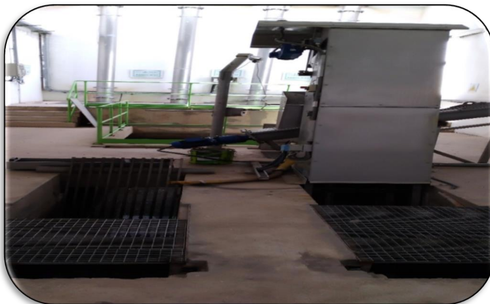
Figure 06: Le dégrillage (Cliché personnel, Mai 2021).
