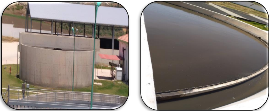
Figure 14: L'ouvrage de dégazage (Cliché personnel, Mai 2021).
