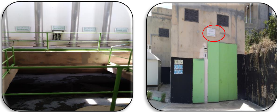
Figure 05: Poste de relevage (Cliché personnel, Mai 2021).
