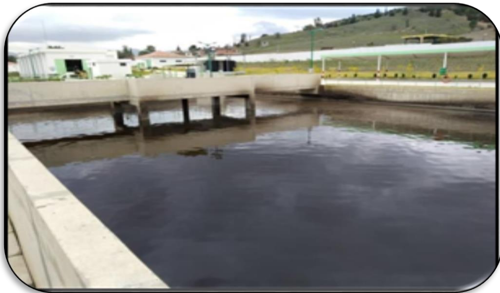
Figure 13: Bassin d'aération (Cliché personnel, Mai 2021).
